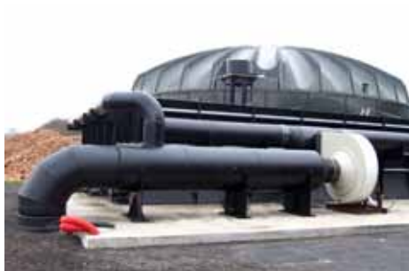
STATIONS D'ÉPURATION DES EAUX USÉES INDUSTRIELLES
